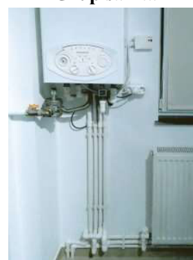
Centrala termică murală pe GN
