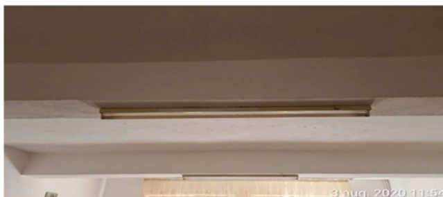
Figura 10 - Corp de iluminat
